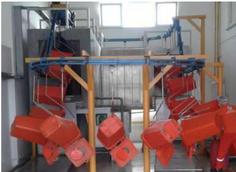
Resim 2:Tıbbi Atık Kovaları Yıkama Ünitesi
